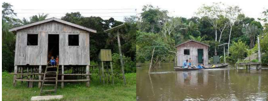
Figura 6 – Sistemas fotovoltaicos domiciliares instalados na comunidade de São Francisco de Aiucá.
